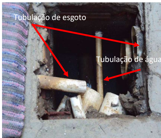
Figura 2: Caixa de passagem com tubulações de água e esgoto
